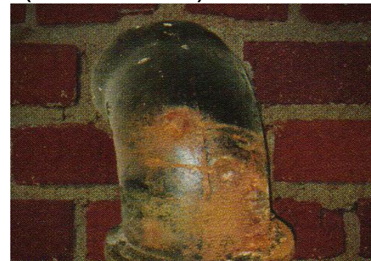
Korrosions- und Geruchsbildung
