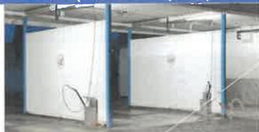
Anlagenteil zur Abwasserbehandlung (z.B. Waschplatz)
