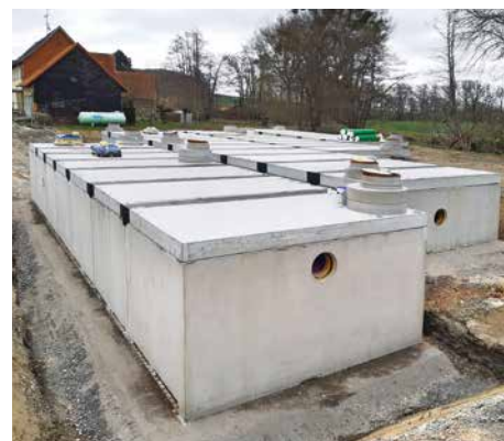
Absetzanlage nach RiStWag NS 210 mit nachgeschalteten Regenrückhaltebecken
