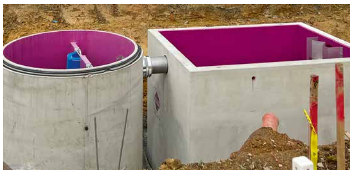
Das Foto zeigt die normgerechte Rohranbindung
