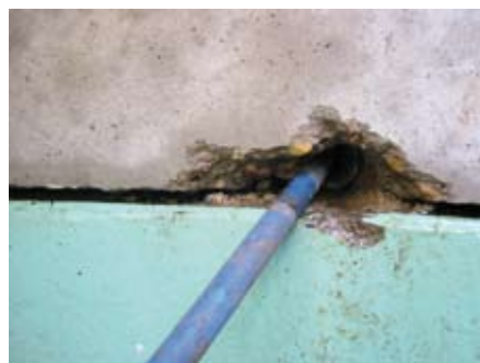
Unfachgemäße Kabeldurchführung (Bild: Prüf-Nord, Hitzacker)
