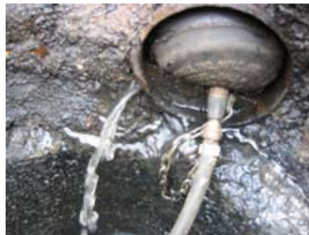
Undichtheit im Bereich der Rohranbindung (Bild: Prüf-Nord, Hitzacker)
