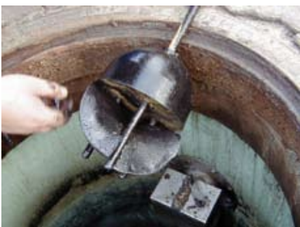
Defektes Dichtgummi der selbsttätigen Verschlusseinrichtung (Bild: Prüf-Nord, Hitzacker)
