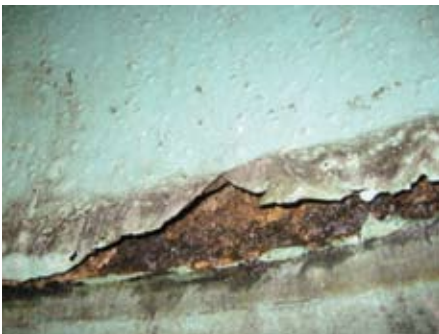
Schadhafte Innenbeschichtung (Bild: Prüf-Nord, Hitzacker)
