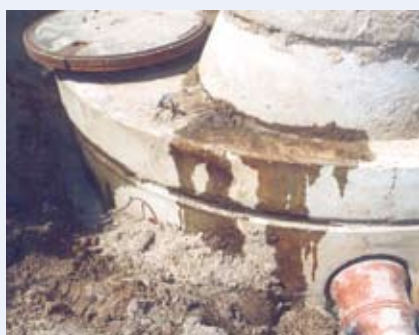
Dies wäre mit größerer Sorgfalt beim Einbau vermeidbar gewesen!
